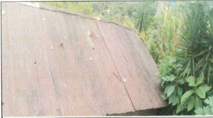
techo en malas condiciones de la cocina del establecimiento
